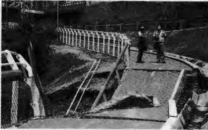
TRECHO de ciclovia Tim Maia, na orla do Rio, desabou
